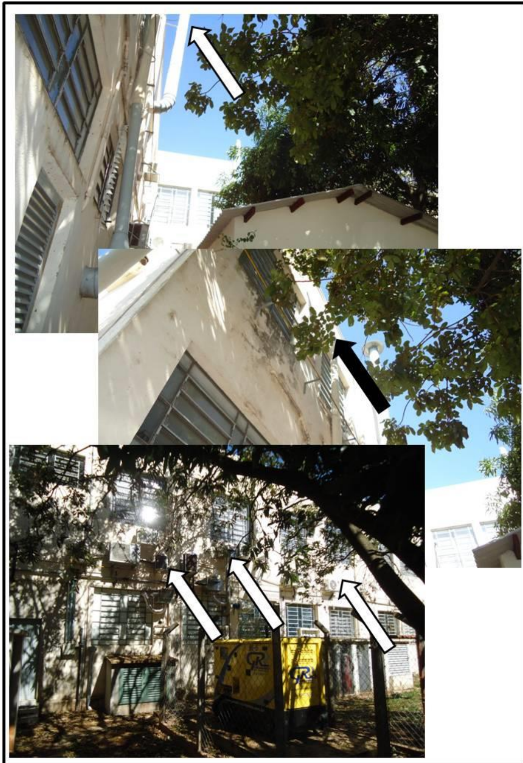
Figura 4. Série de exaustores pelos quais emanam, dentre outros, metais potencialmente tóxicos.
